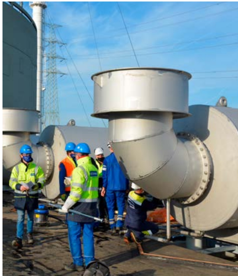
Placement des silencieux. Un coude, suivi d'un silencieux cylindrique Boet Stopson de type réactif, a été placé à l'embouchure des buses. Ainsi le rejet moteur est fortement atténué et dirigé en hauteur et vers l'intérieur du site de la Centrale, et non plus vers les zones d'habitat de Amay.
