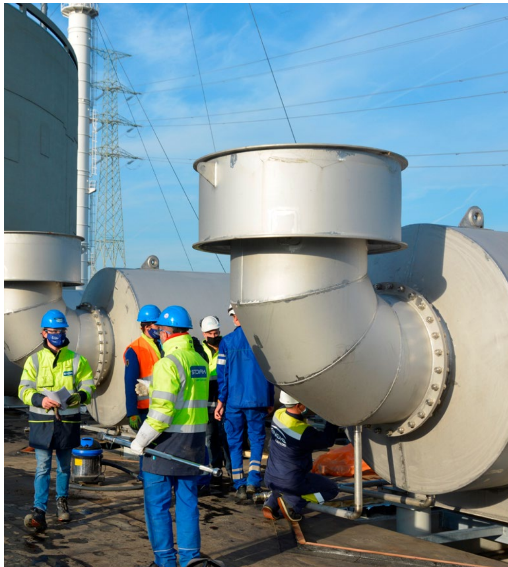
Placement des silencieux. Un coude, suivi d'un silencieux cylindrique Boet Stopson de type réactif, a été placé à l'embouchure des buses. Ainsi le rejet moteur est fortement atténué et dirigé en hauteur et vers l'intérieur du site de la Centrale, et non plus vers les zones d'habitat de Amay.
