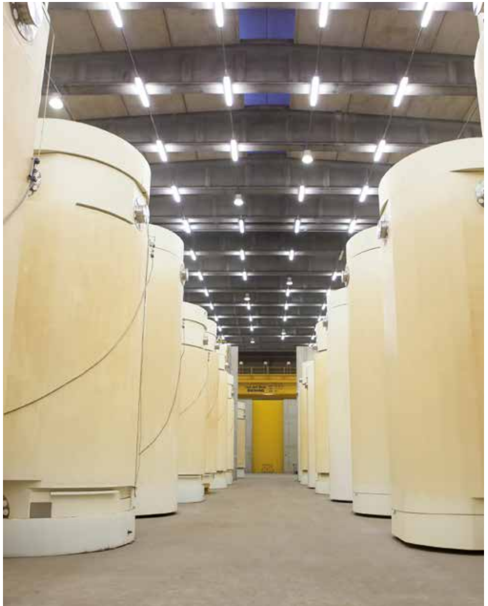
Splijtstofcontainergebouw: elke container kan 24 tot 37 elementen stockeren.
